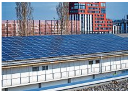
Solaranlage auf dem Dach des Sportparks/Ökihofs in Rotkreuz. z.Vg.
